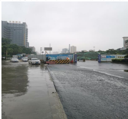
图 2 施工路段积水
