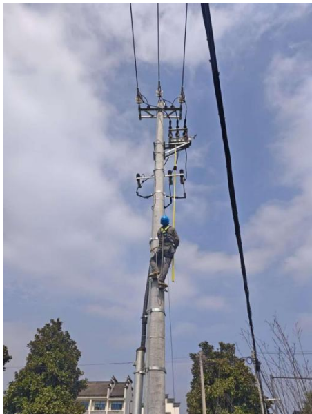
图2 使用柱上开关整定值调节绝缘操作杆现场操作
